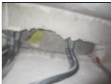
Photo N° 1287 AMIANTE CIMENT -- placards elec rdc à +5 Plafonds Plaques planes (Fibres-ciment)
